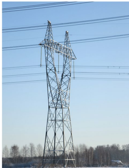
35-750 кВ-ын ЛЭП цахилгаан дамжуулах шугамын тулгуур
