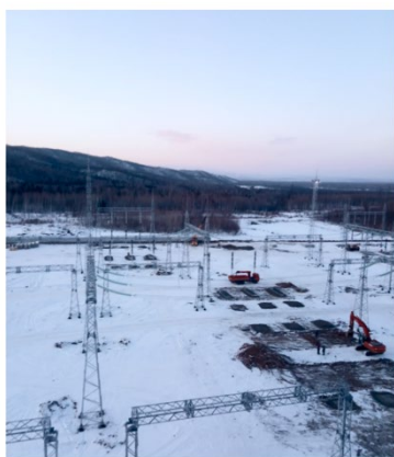
Порталы ошиновки распределительных устройств ОРУ, ПС
